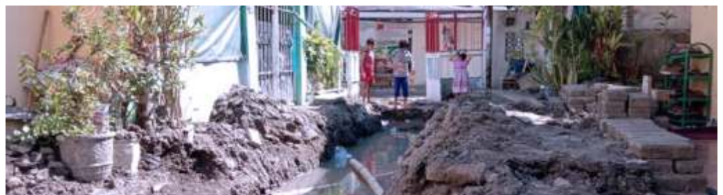
Paving yang ambles akibat tak tuntasnya pembangunan box culvert di Kelurahan Krembangan, Surabaya
