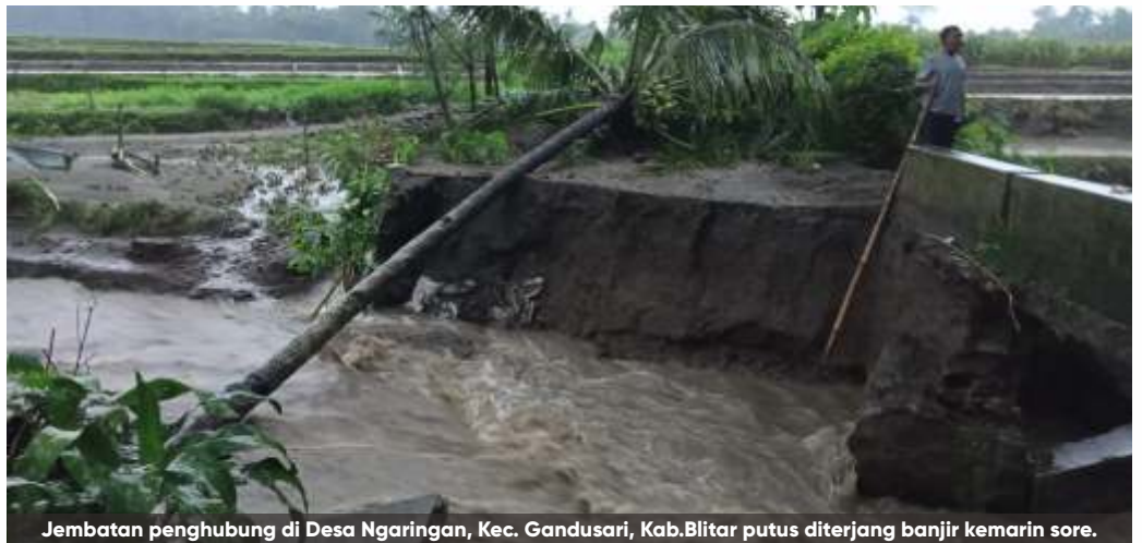
Jembatan penghubung di Desa Ngaringan, Kec. Gandusari, Kab. Blitar putus diterjang banjir kemarin sore.
