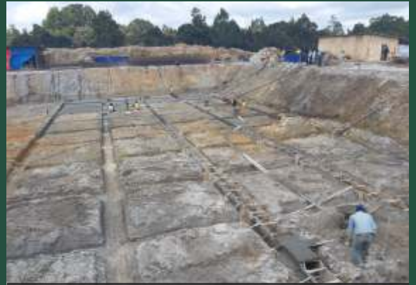
Pelaksanaan pekerjaan proyek konstruksi di kawasan food estate, Desa Riaria, Kec. Pollung, Kab. Humbang Hasundutan (Humbahas), Sumatera Utara, diduga abaikan Kesehatan dan Keselamatan Kerja (K3).
