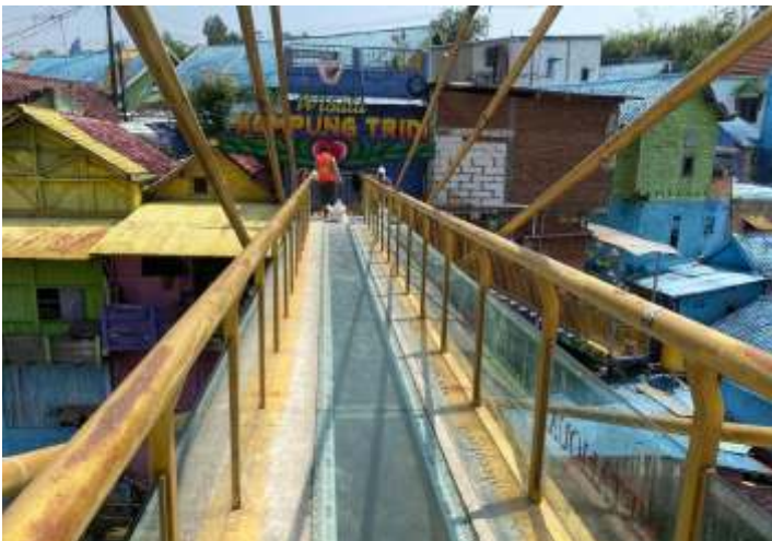
Kondisi saat petugas sedang memperbaiki jembatan kaca penghubung antara Kampung Tridi dan Kampung Warna-warni Jodipan Kota Malang. (Dok. DPUPR-PPK Kota Malang)
