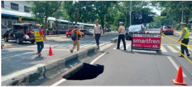
Aspal ambles berukuran 2 meter di Jalan Bandung, Kota Malang, Kamis (7/12/2023). (Santi/Lenteratoday)
