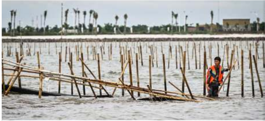
Nelayan membongkar pagar laut yang terpasang di kawasan pesisir Tanjung Pasir, Kabupaten Tangerang, Banten, Sabtu (18/1/2025). (Dok)
